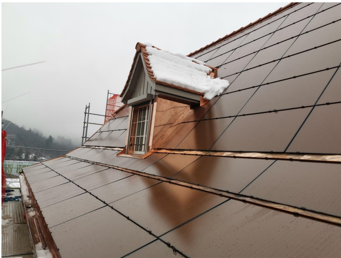
Abbildung 4: Photovoltaik Indach-Anlage mit speziell eingefärbten Modulen (Pfarrhaus Ittigen, Sonnenrain 7)
