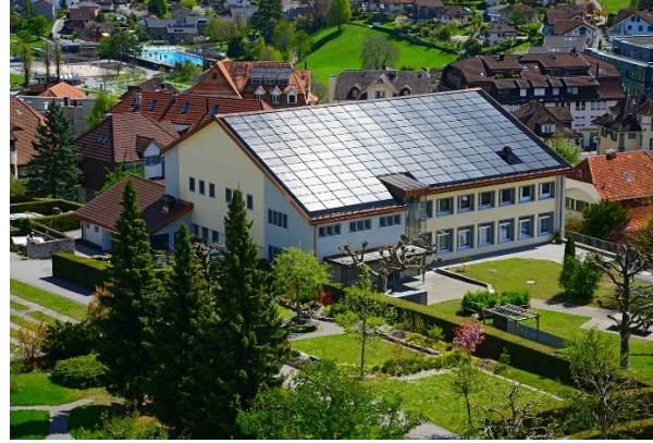
Abbildung 6: Photovoltaikanlage der Kirchgemeinde Spiez
